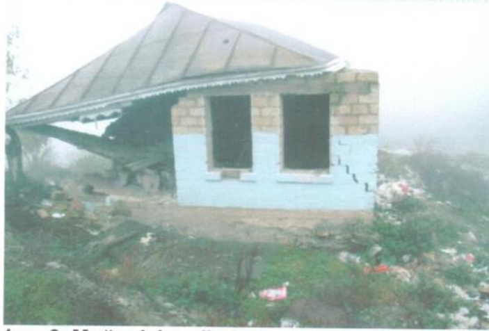
Şəkil 1 və 2. Muğanlı kəndində sürüşmədən zərər çəkmiş ev.
