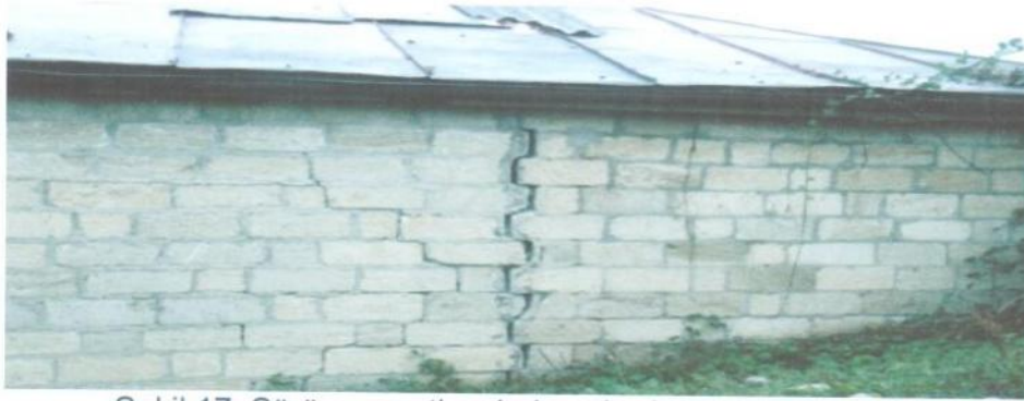
Şəkil 17. Sürüşmə nəticəsində evlərdə yaranmış çatlar.
